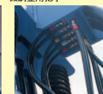
偏心モーメント制御配管部
